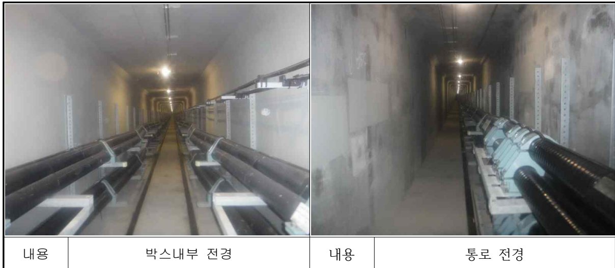
[사진 3.1] 신가평-미금 전력구 현황
